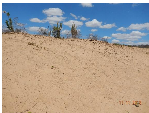
Foto 57 - Vista frontal do talude.
