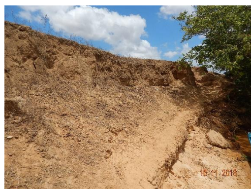
Foto 36 - Vista frontal do talude.
