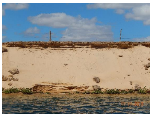
Foto 68 - Detalhe do solapamento da base do talude.
