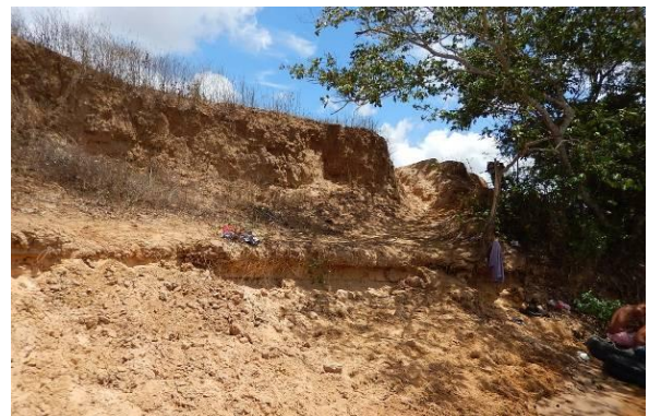
Foto 36 - Vista frontal do talude.
