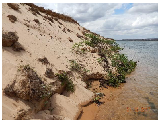
Foto 67 - Detalhe do solapamento da base do talude.
