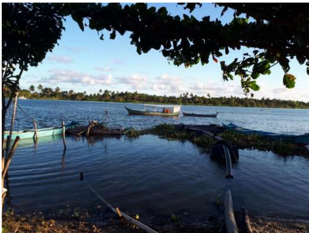
Figura 3: Bomba de captação de água da cidade de Penedinho-AL.
