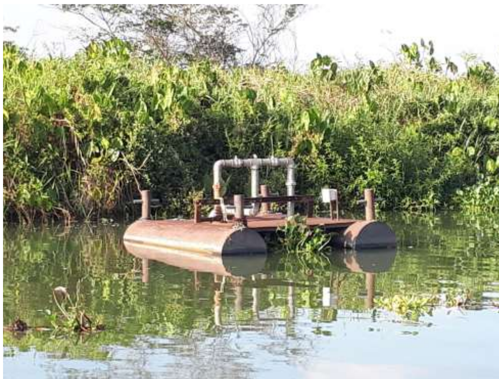
Figura 3: Bomba de captação de água da cidade de Brejo Grande - SE.
